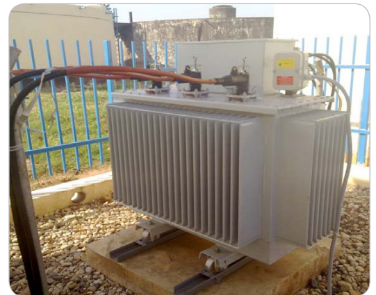
Transformateur 250 KVA (projet Burundi)
